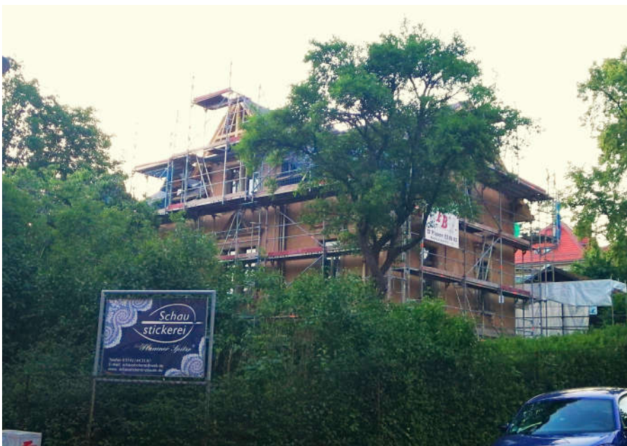
Am Gebäude der Schaustickerei steht das Gerüst und die Arbeiten sind in vollem Gange
