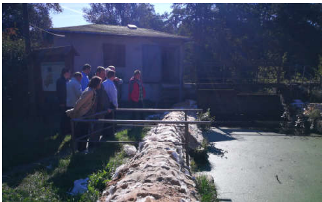
Das alte Wehr ist notdürftig mit Sandsäcken gesichert, deren Zustand durch Wind und Wetter deutliche Zeichen zeigt.
